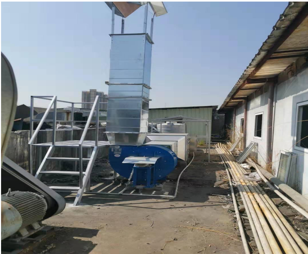
废气处理设施图
