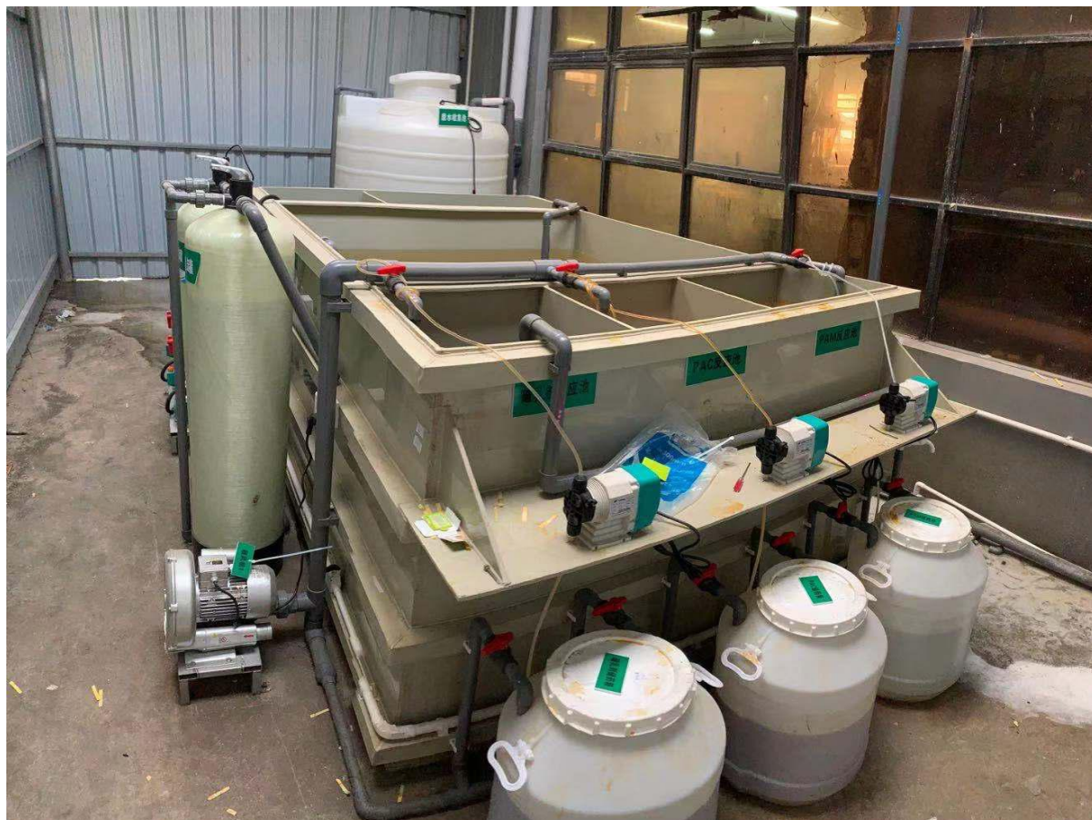
废水处理设施图
